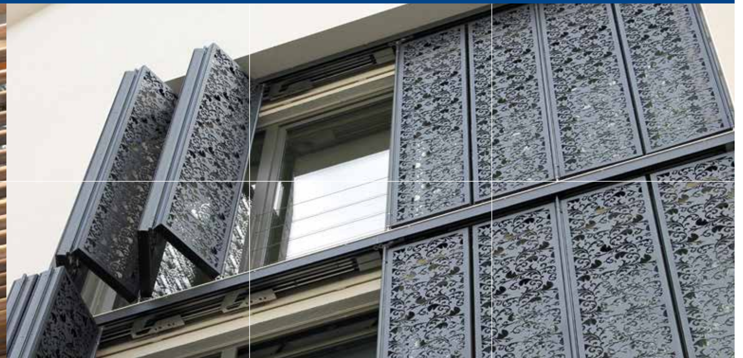
Faltschiebeläden mit Aluminiumblech in interessanter Ornamentoptik.
